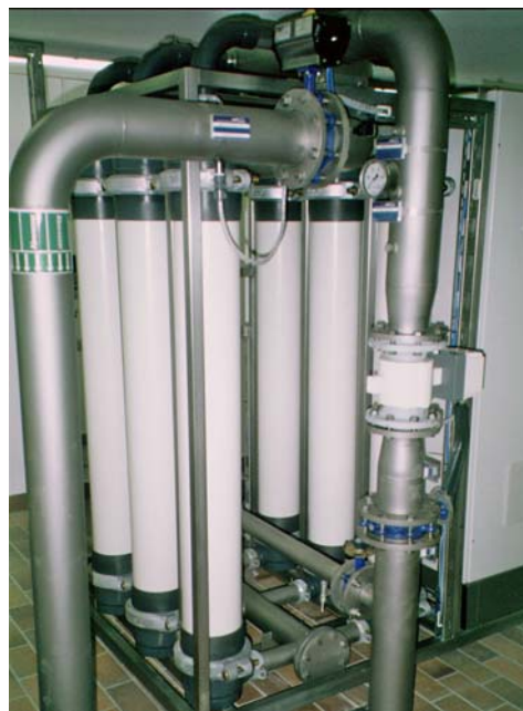
Abb. 1: moderne Wasseraufbereitung mittels Ultrafiltration
